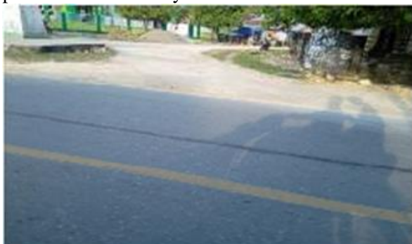
Gambar 13 Jalan Lamodandu di Desa Labunti Kecamatan Lasalepa Kabupaten Muna (Sumber: Dokumentasi Pribadi).
