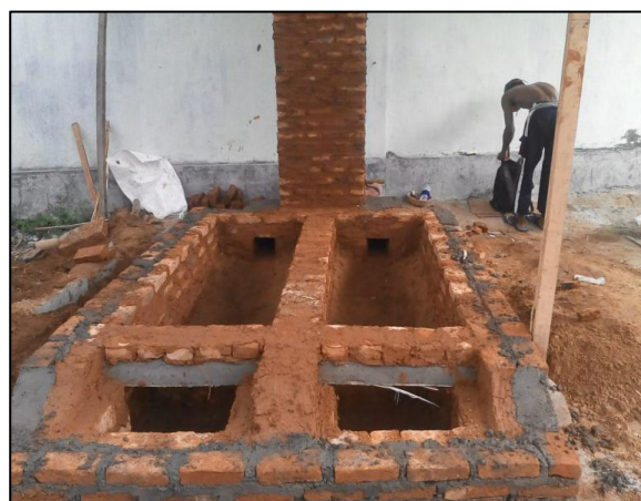
Gambar 1. Konstruksi Tungku untuk Memasak Garam
